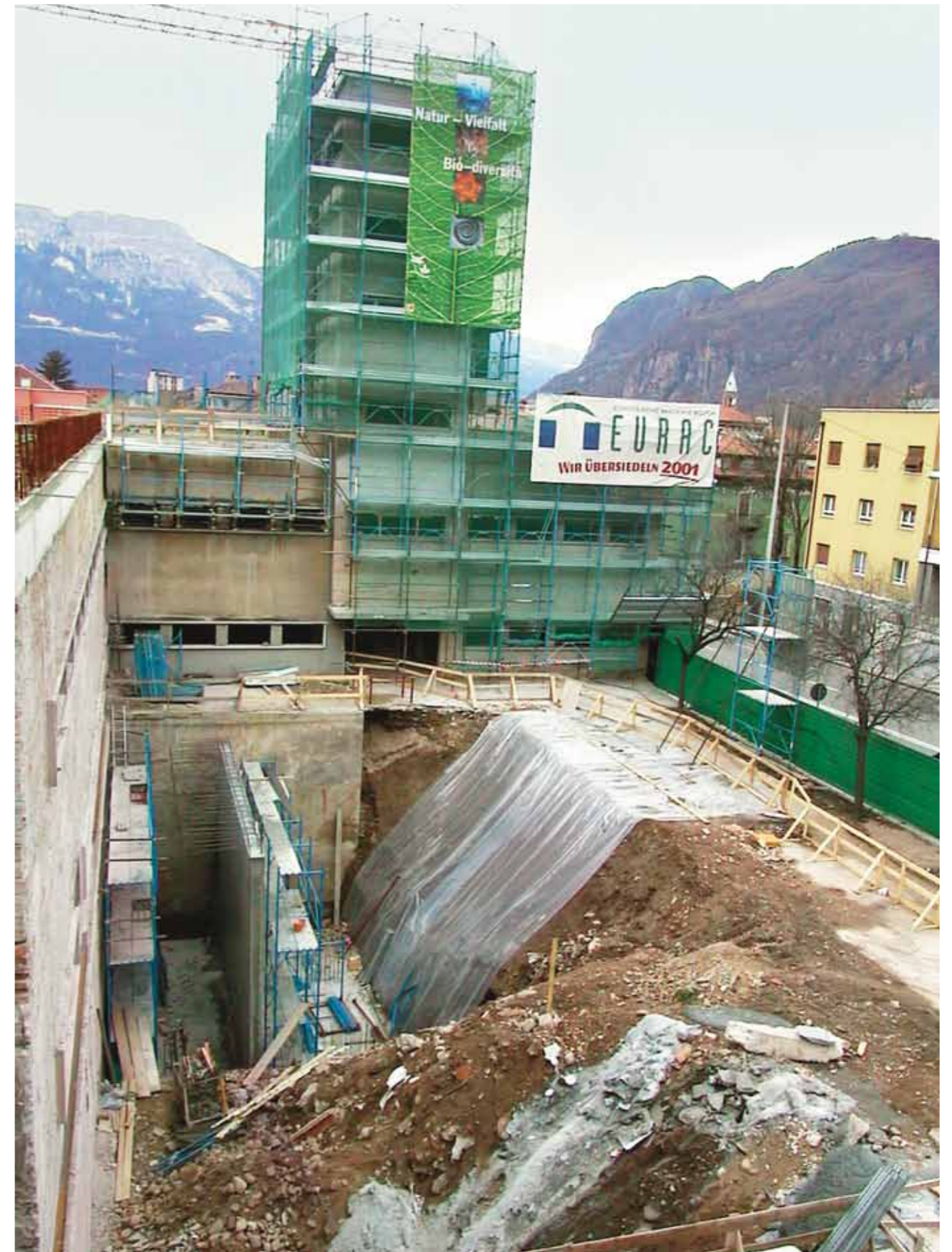
Vista sul cantiere. I lavori per la trasformazione della ex sede della Gioventù Italiana del Littorio in un centro di ricerca all'avanguardia sono seguiti a un concorso internazionale di architettura cui hanno preso parte professionisti del calibro di Kollhoff (Berlino), Gaffetti (Lugano), Gaenßler (Monaco), Pekka Jokela (Helsinki), Zöggeler (Bolzano) e Reichlin (Parigi). L'austriaco Klaus Kada si è aggiudicato l'incarico. (Articolo pagina 35)
