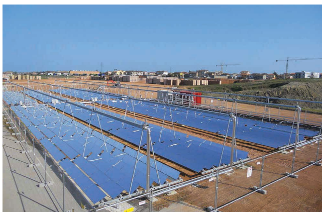
Impianto solare termico di Laterizi Gambettola (Cesena)
