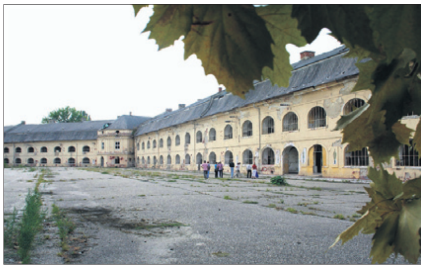
Fallande rappning, hål i taken, mögel och fuktskador är verklighet i fortets kaserner. Men likväl är byggnaderna viktiga minnesmärken. FOTO: KENNETH MYNTTI
